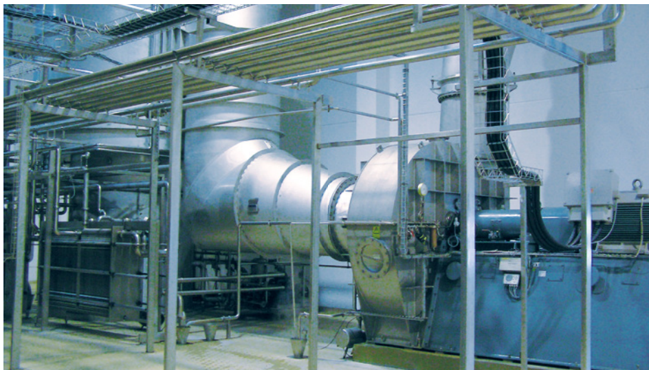
Ventilator in einer Brüdenanlage
