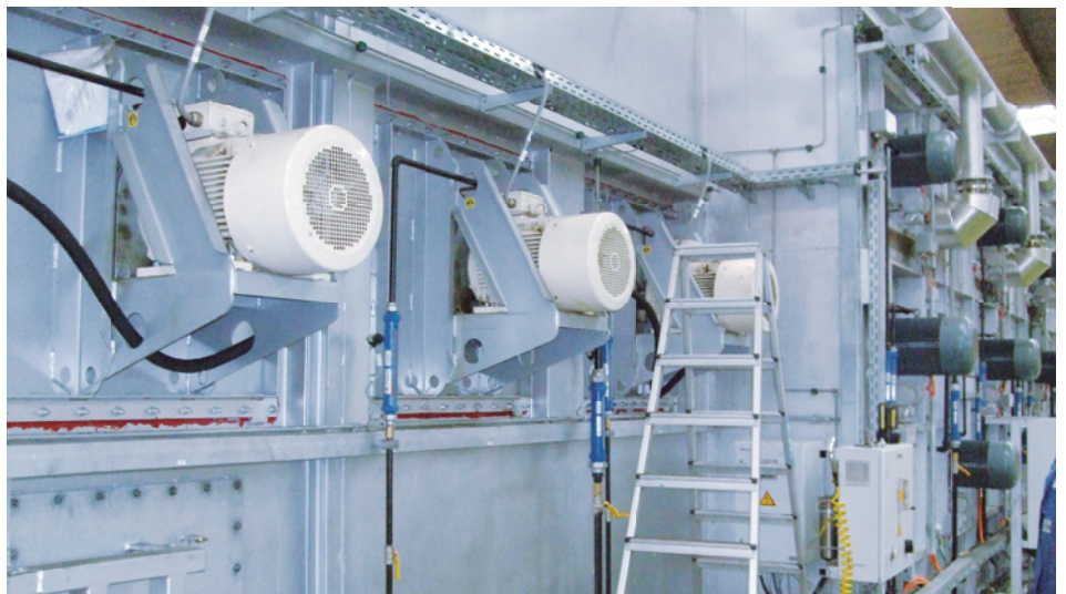
Ventilatorenantriebe Banddurchlaufofen zur Wärmebehandlung von Metallbändern Foto freigegeben von Aurubis AG
